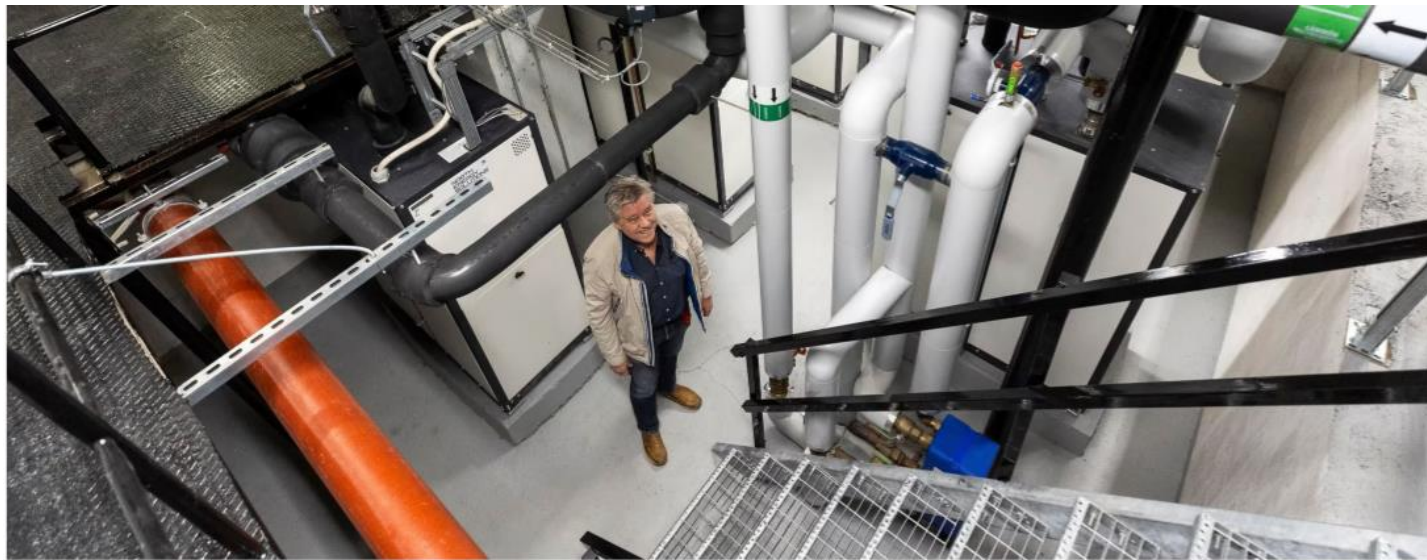
Kiinteistövastaava Pasi Oldén Sammonkartanon lämmönjakokeskuksessa Tampereen Kalevassa. Vanha varastokäytössä ollut pannuhuone on tupaten täynnä uusia laitteita ja putkia.
